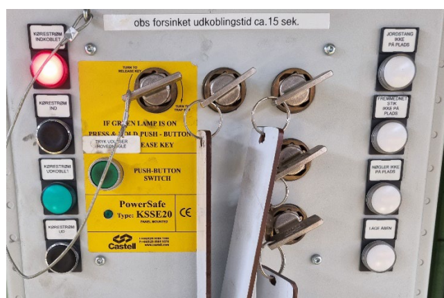
Fig. Betjeningskasse (lys i grøn lampe = kørestrøm udkoblet).
